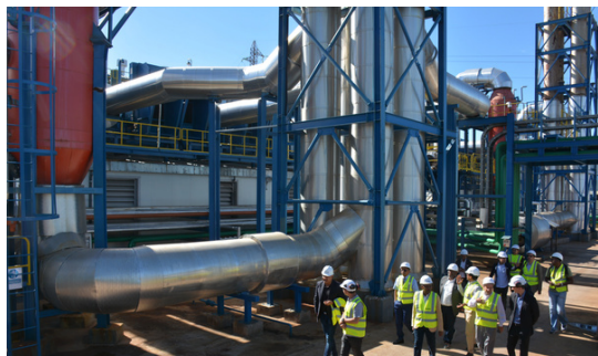
Une centrale électrique produisant de l'énergie à partir de la bagasse à La Réunion (2018)
